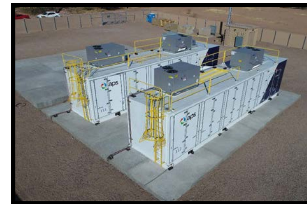
Punkin Center - 2MW (8 MWh)
